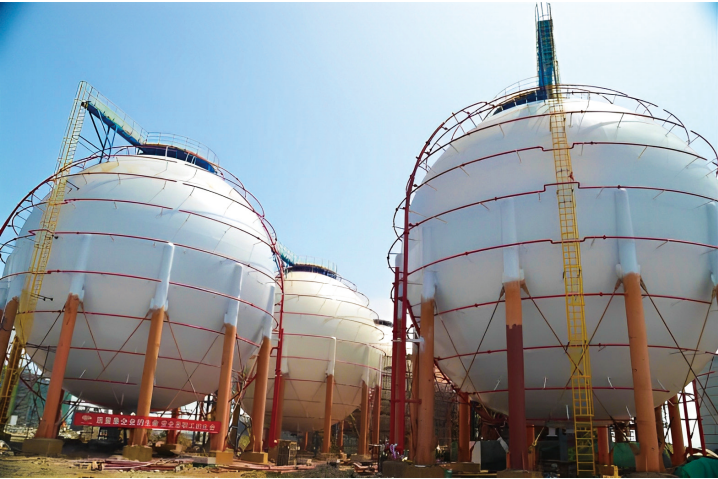
图 1-21 丙烯压力储罐
